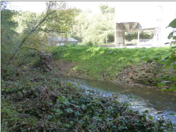
Ancien mur écroulé
