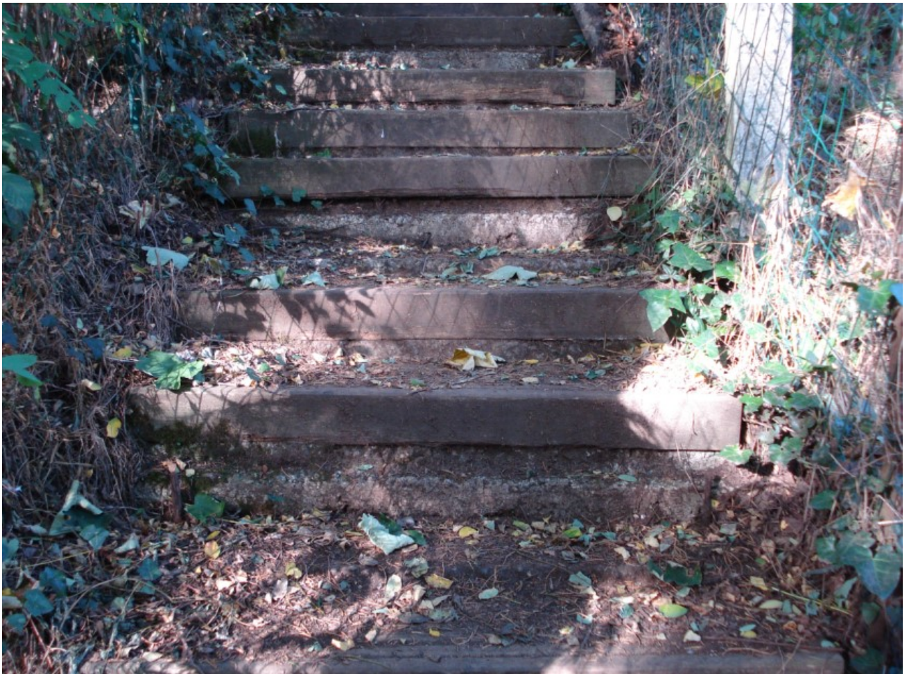
Escalier effondré aux « Roches Brunes »
